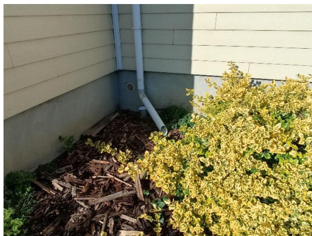
Figure 2 : Gouttière dirigée vers l'espace vert (Beaupréau-en-Mauges)
